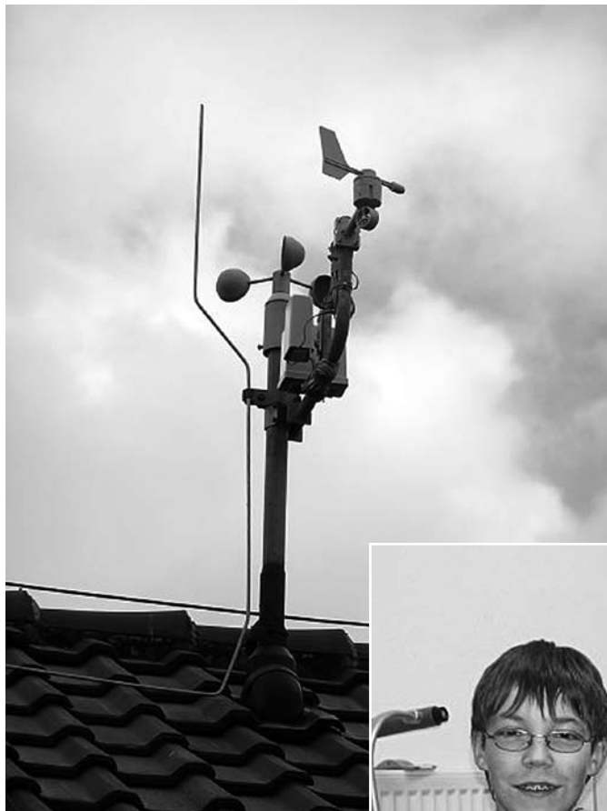
Die sturmsichere Befestigung der Komponenten an einem Mast auf dem Schuldach über dem Chemieraum 118.
